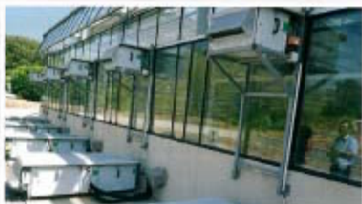
圖7. 農學研究發展國際合作中心 (CIRAD) 基因轉殖植物隔離溫室的排氣是經過HEPA過濾系統 (相片上方裝置)，對防止花粉飛散至溫室外具高等級的防護，相片下方裝置為溫室內加溫溫水產生器。
