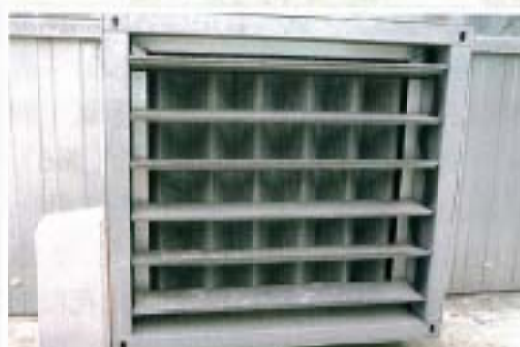
圖6. 法國國家農業技術研究院 (INRA) 基因轉殖植物隔離溫室是以一般抽風扇方式排氣，排氣風扇外部設有除塵網以防止溫室內花粉飛散至溫室外。
