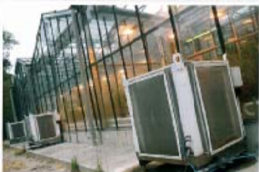
圖4. 法國發展研究院 (IRD) 基因轉殖植物隔離溫室的進氣是以冷氣冰水式空調機方式將冷空氣送入溫室，進氣裝置外部均包覆有防蟲網的設置。
